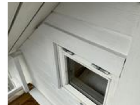
Ikke skråstilt vannbord.
