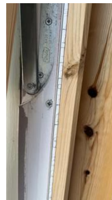
Eksempelbilde av oppsprukket pakninger.
