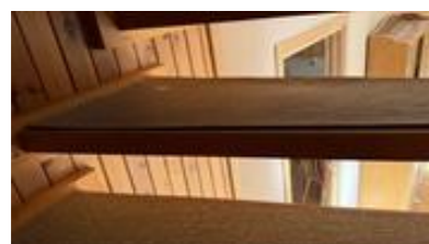
Eksempelbilde av løst belegg i trappetrinn.
