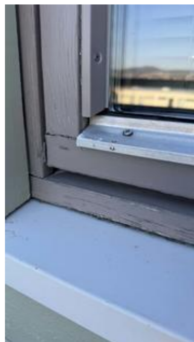
Eksempelbilde av værslitasje/ malingsavflass.
