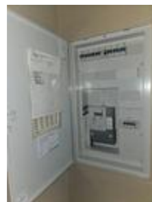
Sikringskap med automatsikringer og kursfortegnelse
