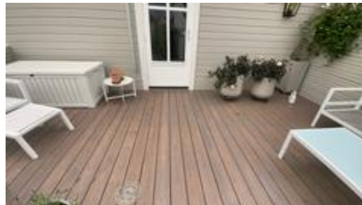
Ikke tilstrekkelig avstand mellom kledning og terrasse.
