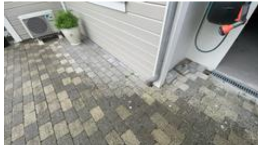
Kledning ned i terreng.
