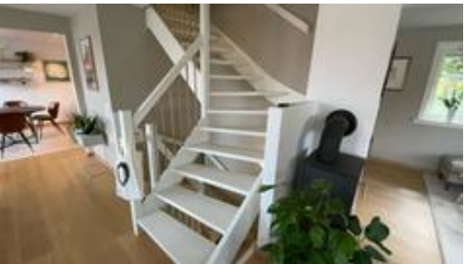
Rekkverk mangler i nedre del.
