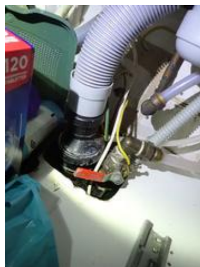
Det registreres drypplekkasje fra koblingspunkt ved stoppekran.
