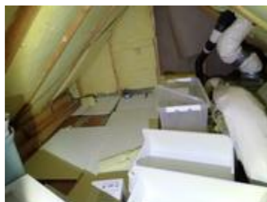
Feil oppbygging med isolering mot takkonstruksjon.
