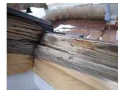
Råteskade i karm.
