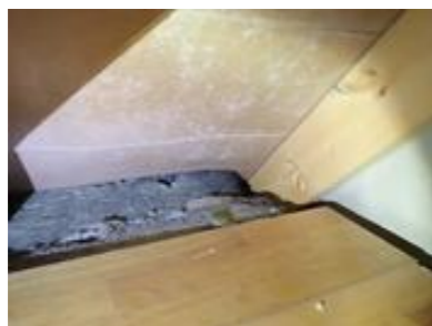
Stedvis misfarging i undertak i nedre del mot islasjon.
