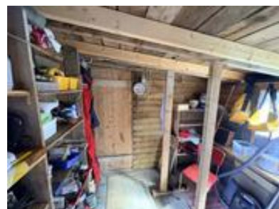
Selger har utført avstivning etter nedbøy i takkonstruksjonen. Funksjon og bæreevne vurderes foreløpig ikke som kritisk påvirket.
