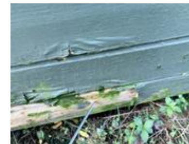
Eksempel på malingsavflassing på kledning.
