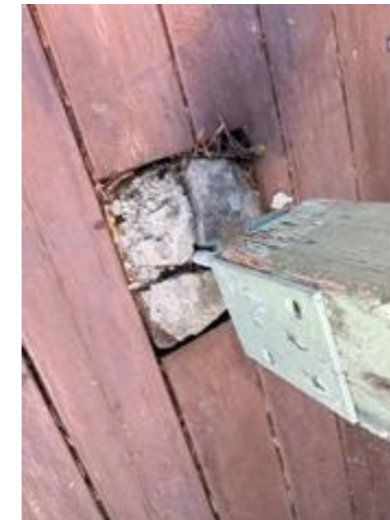
Skader på søylepunkt ved inngangsparti.
