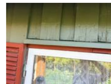
Eksempel på værslitt oppsprukket kledning.
