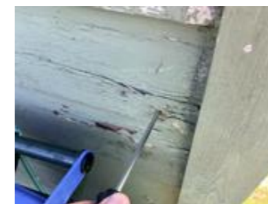
Lokal råteskade på deler av kledning bod/inngangsparti.
