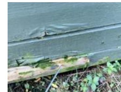
Eksempel på malingsavflassing på kledning.
