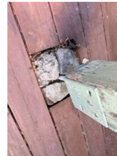
Skader på søylepunkt ved inngangsparti.
