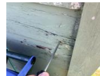
Lokal råteskade på deler av kledning bod/inngangsparti.
