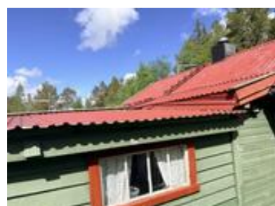
Deler av tak mangler renner og nedløp som vil gi økt uønsket fuktbelastning mot veggkonstruksjonen.
