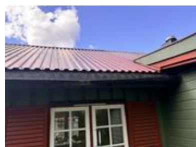
Skjevheter og nedbøy på takrenne.
