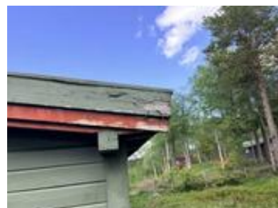
Eksempel på værslitasje og påbegynnende råte i vindskier.
