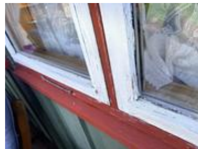
Eksempel på utvendig slitasje.
