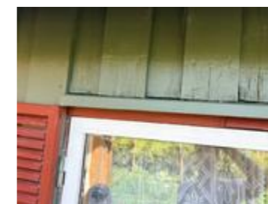
Eksempel på værslett oppsprukket kledning.
