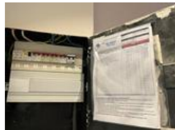
Sikringskap plassert i entre.
