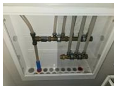
Fordelingskap for tappevann med stoppekran
