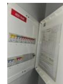
Sikringskap med automatsikringer og kursfortegnelse
