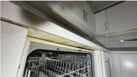
Små sår og hakk i benkeplaten. Påbegynnende svelling i underkant av benkeplaten ved oppvaskmaskinen.
