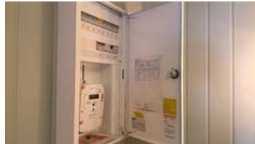
Bildet viser sikringskapp for det elektriske anlegget.
