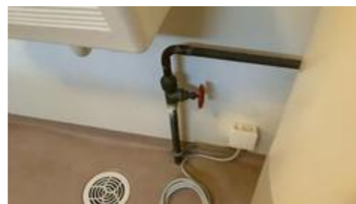
Stengekran på vann.
