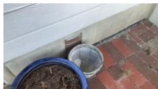
Rust på ventilrister.
