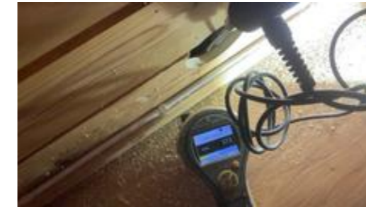
Fuktsøkt i påforet yttervegg i kjeller.
