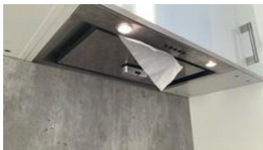
Avtrekk funksjonstestet med papir.
