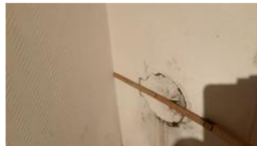
Feieluke kommer for nær brennbart/vegg i kjeller.
