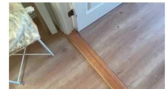
Mangel av terskellister på enkelte innerdører.
