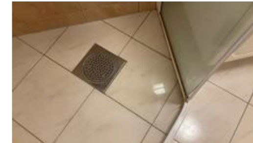
Vann vil ligge igjen på gulv/fliser i dusj etter bruk. 2 ETG > BAD
