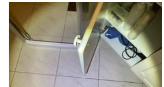
Fuktskade/merke i dør/seksjon.
