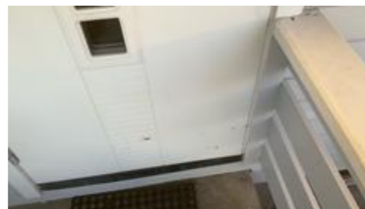
Hovedytterdør med lakkavflassing.
