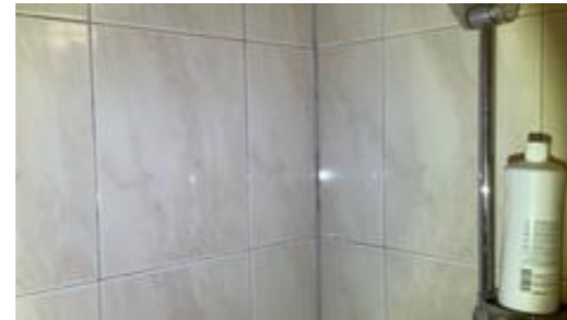
svertesopp i mykfuger dusj. 2 ETG > BAD
