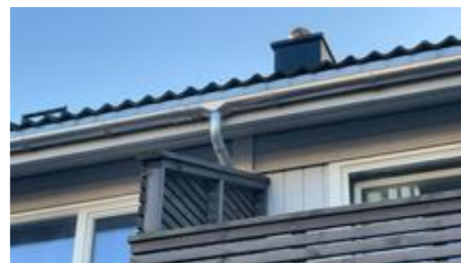
Takrenner/nedløp i aluminium.
