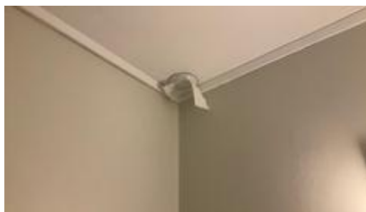
Avtrekk funksjonstestet med papir.
