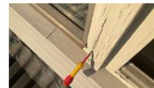
Oppsprikking/avflassing og begynnende råteskader.
