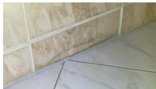
Emaljeriss i veggfliser dusj.
