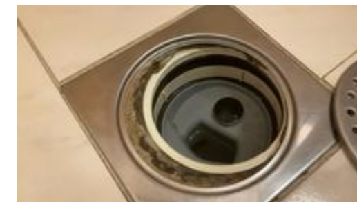
Sluk i gulv.
