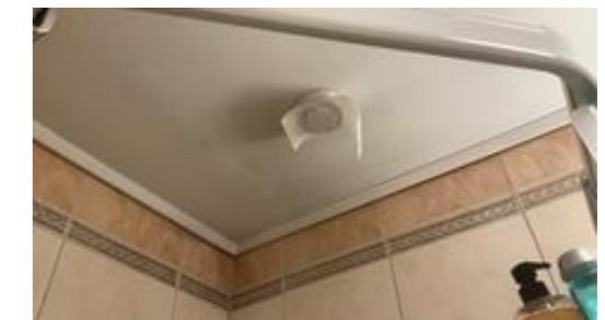
Avtrekk funksjonstestet med papir.
