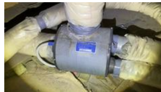
Motor for ventilasjonsanlegget.
