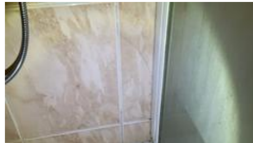
Flis på vegg i dusj med sprikk.
