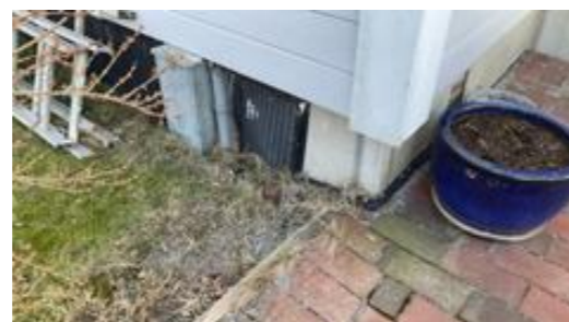
Fuktsikring viser på mur.
