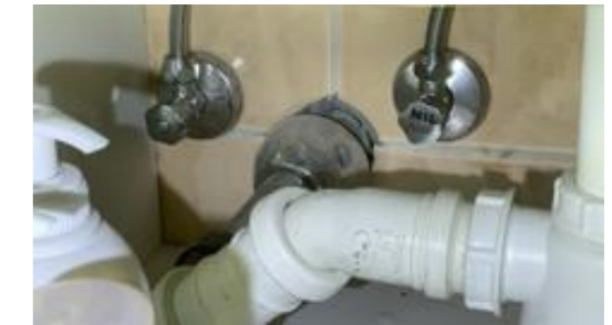
Ikke fuktett rørgjennomføring i vegg under vask.
