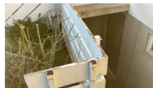
Værslitt overflater på rekkverk.
