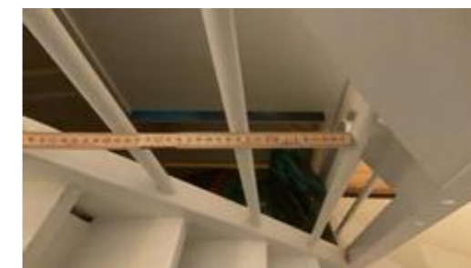
Større åpninger mellom spiler i rekkverk.
