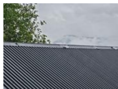
Belegget på mønebeslagene har begynt å løsne
