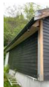
Det er ikke nedløpsrør på takrennene
