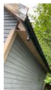
Det er ikke nedløpsrør på takrennene
