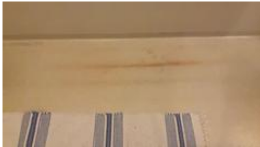
Merker etter varmekabler.
