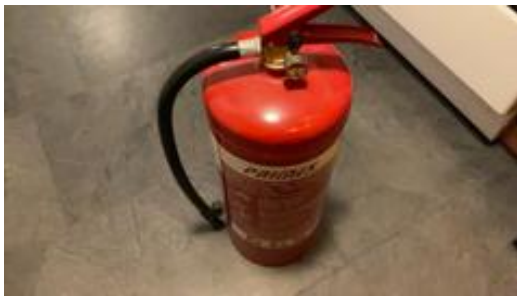
Brannslukker skal ha neste kontroll 2027
