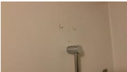
Borret hull i vegg over dusjstang.
