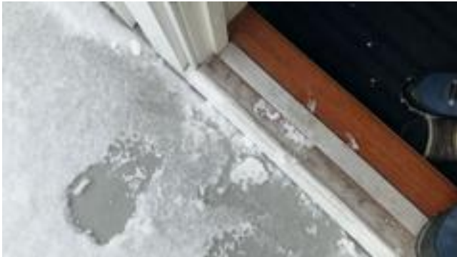
Ikke fagmessig bord/list på terskel terrassedør.
