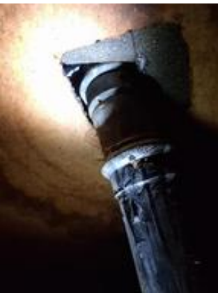
Usikret rundt rør i taket
