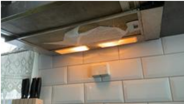
Ventilator funksjonstestet med papir.
