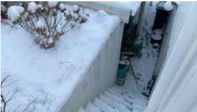
Trapp uten rekkverk på vange.
