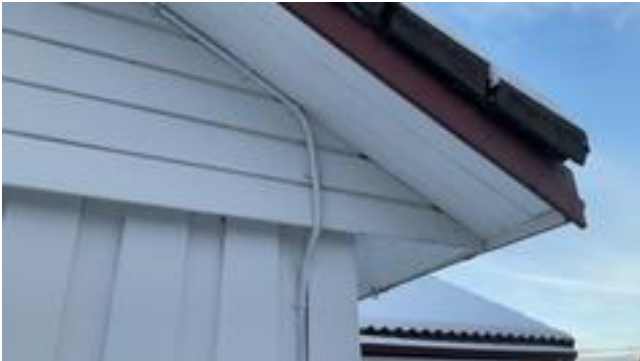
Svertesopp på enkelte overflater.
