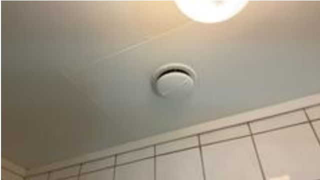
Ventil i tak for naturlig lufting.
