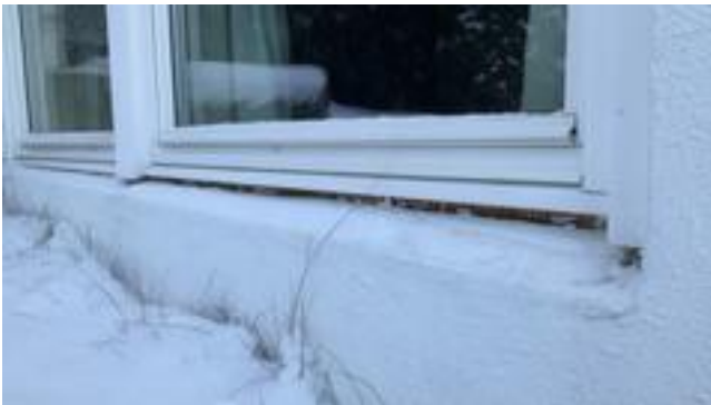
Mangelfull innpussing/beslag under vinduer i kjellerstue.
