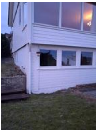
Område med observasjon av rottehull
