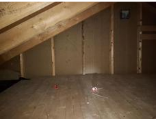
Område på loft med rotteekskremer
