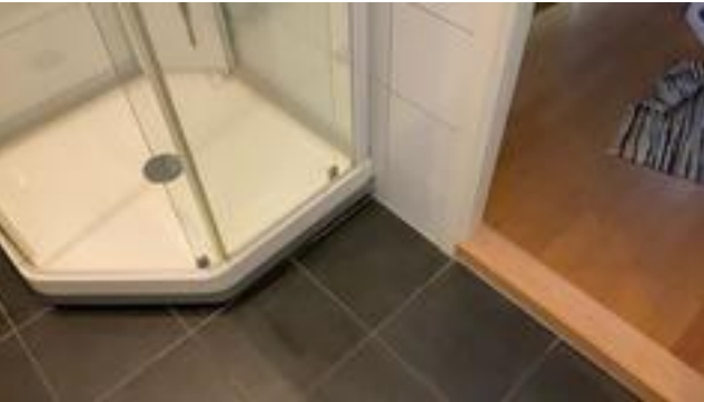
Dør plassert i dusjens fuktsone.
