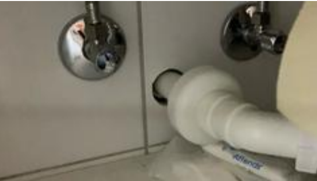
Ikke fuktett rørgjennomføring i vegg under vask. 1 ETG > BAD
