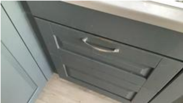
Bruksslitasjer/merker på enkelte dører/fronter.
