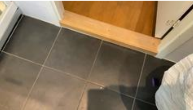
Bl.a ett område på gulv med bom/hulrom under fliser. 1 ETG > BAD
