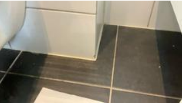
Mindre skade i flis ved toalett. 1 ETG > BAD
