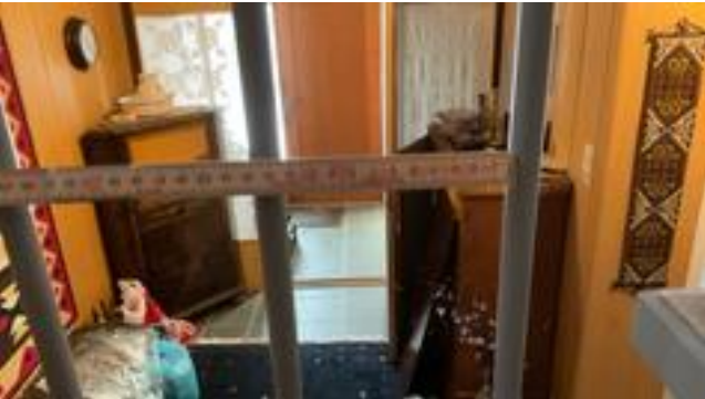
Åpninger over 10 mellom spiler i rekkverk.
