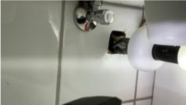
Ikke fuktett rørgjennomføring i vegg under vask.
