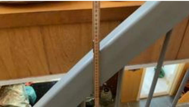
Lavt rekkverk i trappeløpet.
