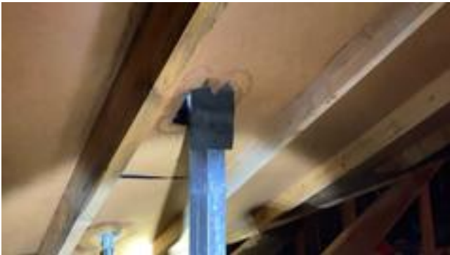
Uisolert loftekanal/rør, fuktmerker rundt gjennomføringen.
