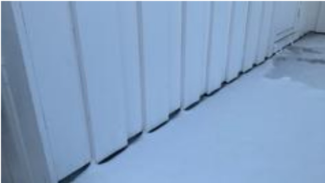
Oppsprikking av bordkledning på nedre del/stu.
