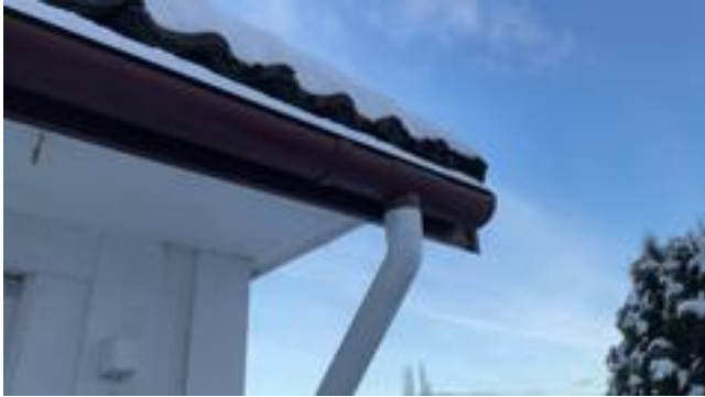
Takrenner/nedløp i plast.
