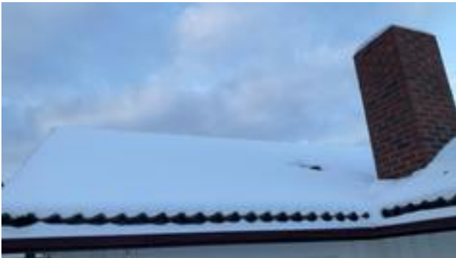
Snø på tak/tekking.
