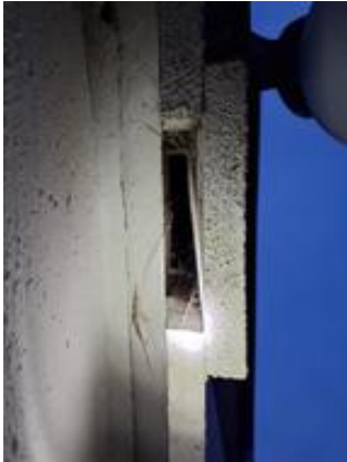
Ingen gnagersikring opp under stående kledning
