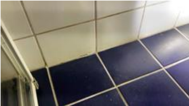
Misfarging og sprikk i mykfuger.
