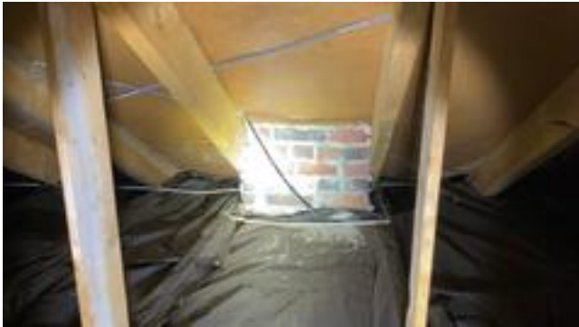
Pipe sett ved tagjennomføringen.
