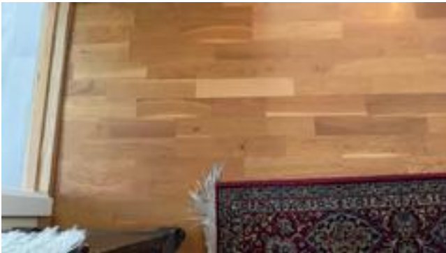
Skade/merke i parkett, her ved dør/åpning til kjøkken.
