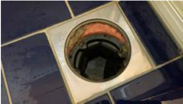
Sluk i gulv.
