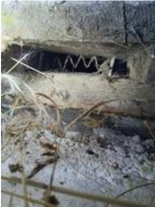
Mangelfull sikring opp under stående kledning
