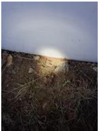
Potensielt rottehull langs fasade
