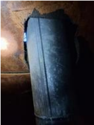
Mangelfull sikring rundt rør i taket
