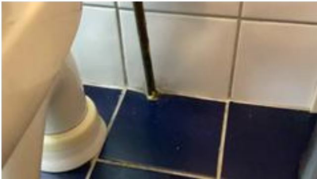
Rørgjennomføring uten mansjett/oppbrett på rørstammen.
