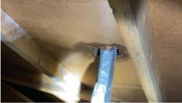
Fukt rundt rørgjennomføringer
