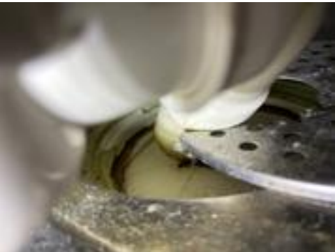
Sluk under dusjkabinett.
