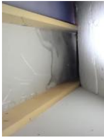
Eksempel på luktemerker i brannskille (gips) mot tilstøtende boenhet.
