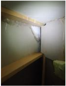
Eksempel på luktemerker i brannskille (gips) mot tilstøtende boenhet.
