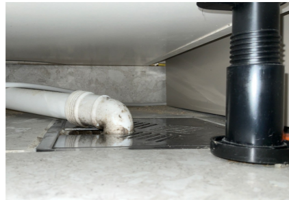
Plastsluk i gulv
