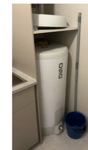
Bereider plassert på vaskerom.
