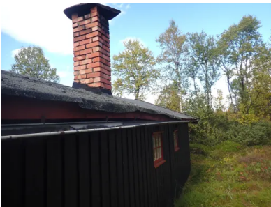
Eksempel på store deformasjoner i takkonstruksjon.
