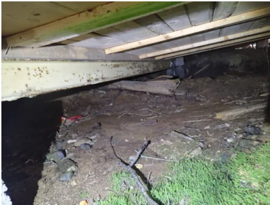
Bilde oppunder konstruksjon hvor det er mulig å komme til med kamera. Man ser blant annet avfarging av fuktpåvirkning i treverket.
