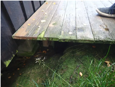
Eksempel på slitasjegrad og nedbrytning i trevirket.
