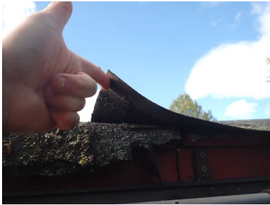
Løsnet pappskjot. Videre er løsningen ved takfoten ufagmessig.
