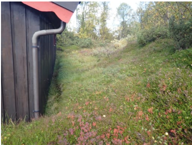
Bilde av terreng med fall mot boligen.
