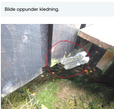
Stikkprøve i kledning med skadesymptom.
