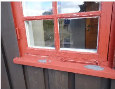
Eksempel på karmslitasje.
