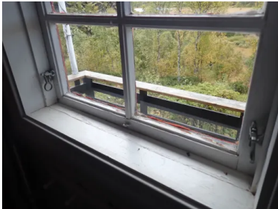
Eksempel på karmslitasje.
