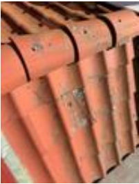
Mosegroing og sprekker i takstein
