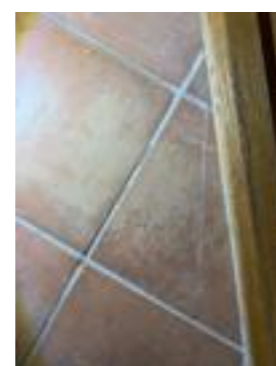
Sprekker i flere baderomsfliser.
