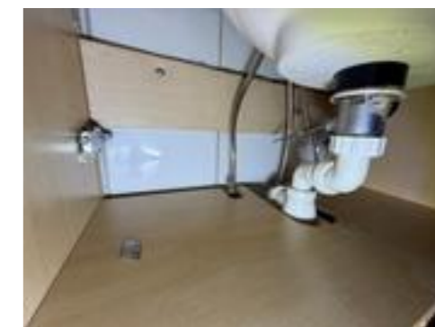
Røropplegg i servantskap
