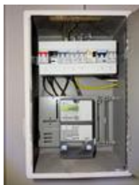
Elskap, plassert i felles trappegang.
