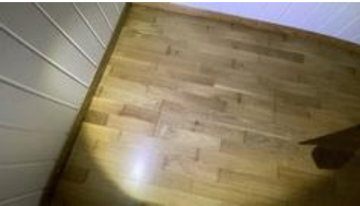
Fuktmerker i skjøter av parkett i bod.
