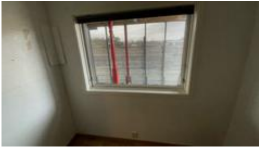
Vindu i soverom gikk ikke opp på befaringsdagen.
