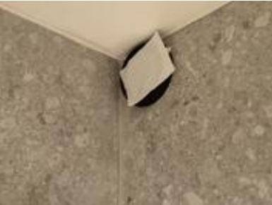
Avtrekk er funksjonstestet.
