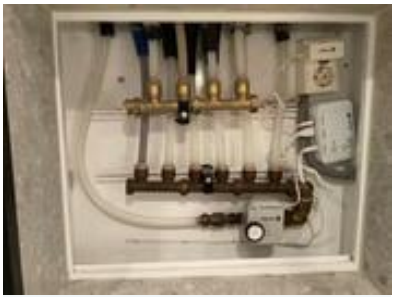
Rørskap er plassert på bad.
