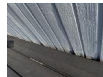
Antydninger til påbegynnende råte på takterrassen bak terrassebordene.
