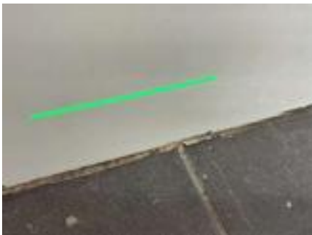
Sprekk i mykfuge mellom vegg og gulv.
