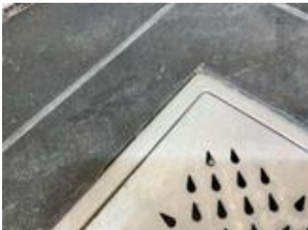
Sprekk i fuge ved sluk.
