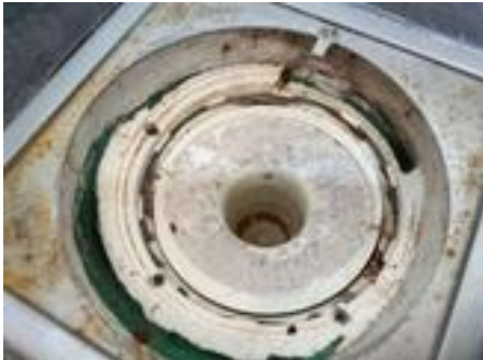
Sluk i dusj med synlig mansjett under klemring.
