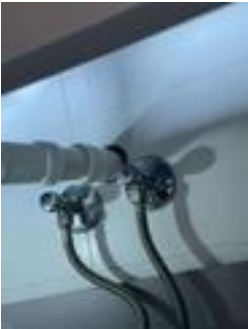
Manglende tetting ved avløp under servant.
