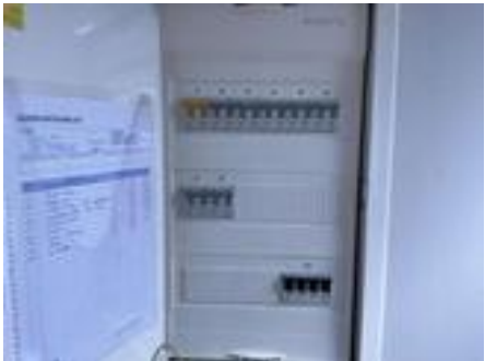
Sikringsskap for garasje og stikk i kjeller.
