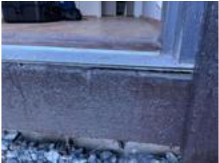
Åpning under terskel på hoveddør.
