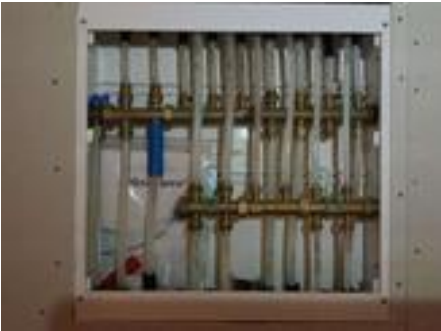
Fordelerskap rør i rør.
