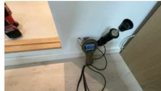
Fuktmålinger i vegg.
