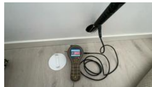
Fuktmålinger i vegg i stue.
