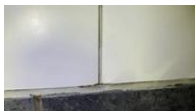
Eksempelbilde av område med svelling i baderomsplate og åpning/ sprekk i fugemasse.
