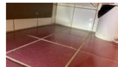
Bildet viser oppsprekking i mykfug i overgang gulv og vegg.
