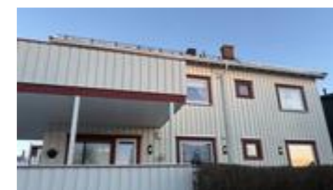
Bildet viser at det kun er etablert snøfanger på deler av taket og at det er en takstige som kun er festet med bøyler over mønet.
