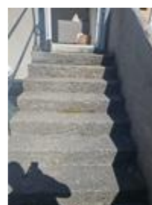
Utvendig trapp tilhører seksjonen. Trappen har en del slitasje
