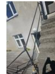
Rekkverket langs den utvendige trappen er ikke iht dagens standard. Nedre del av rekkverket, ca en meter lengde, er skjevt / løst.
