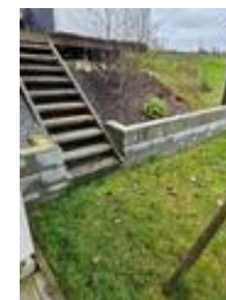
Trapp med for korte inntrinn.
