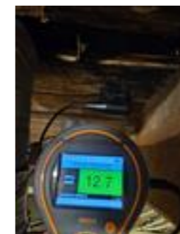
Måling av trefukt ved lekkasjepunkt.
