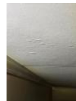
Symptomer på fuktskade i himling.
