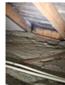
Fuktmerker og soppvekst som følge av kondens.
