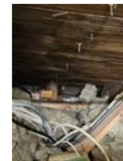
Svertesopp i undertak som følge av kondensproblematikk.
