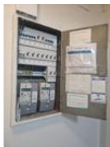
Sikringskap med automatsikringer og kursfortegnelse
