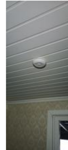
Bilde 1 1 etg. Kjøkken. Røykdetektor piper grunnet trolig mangel på batteribytte.
