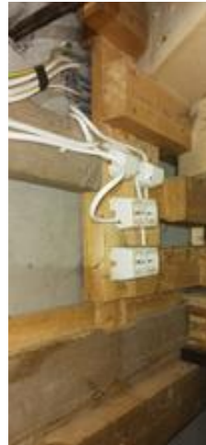
Bilde 1 Kjeller, hobbyrom. defekt stikk.
