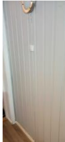
Bilde 1 1 etg. Gang. Kabel fra gulv til bryter, er ikke beskyttet mot mekanisk påkjenninger.
