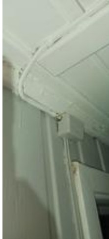
Bilde 1 2 etg. Gang. Løkk til koblingsboks er løs.
