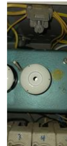
Bilde 4 Glasslokk på sikrings-holdere mangler.
