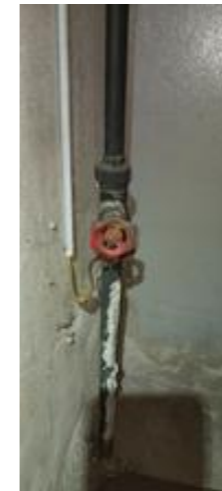
Bilde 1 Hovedvannledning blir benyttet som jordelektrode og er lokalisert tilkoblet i kjeller i tidligere fyrrom. Etablering av ny elektrode anbefales.
