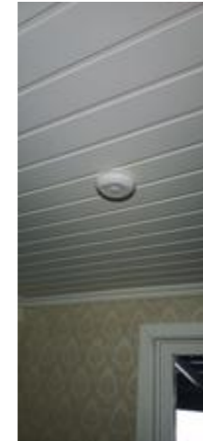
Bilde 1 1 etg. Kjøkken. Røykdetektor piper grunnet trolig mangel på batteribytte.
