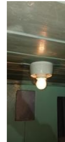
Bilde 2 Kjeller. Lampe i vaskerom mangler kuppel.
