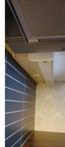
Bilde 1 Lysrørarmaturer under overskap på kjøkken anbefales byttet til lyskilder med Led. Det mangler lysrør i 2 stk. armaturer.
