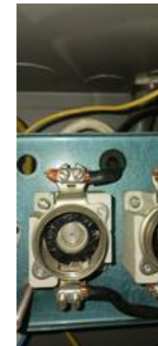
Bilde 3 Det mangler niter på en av ledere (L1) på hovedsikring.
