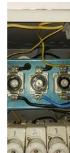
Bilde 2 Bunnskruer sjekket, noe misfarge på hovedsikring fase L2 (blå leder).
