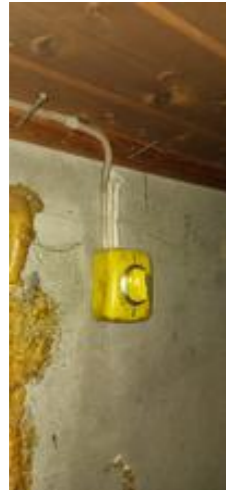
Bilde 1 Kjeller, gang. Bryter/installasjon for oljebrenner kan med fordel fjernes.
