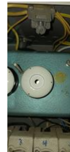
Bilde 4 Glasslokk på sikrings-holdere mangler.
