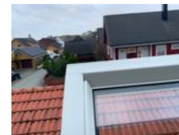
Påegynnende slitasje i maling.
