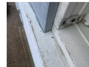
Påegynnende slitasje i maling.
