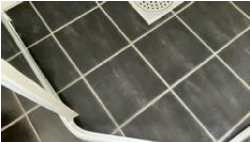
Bl.a bom/hulld under enkelte fliser på gulv i dette området.
