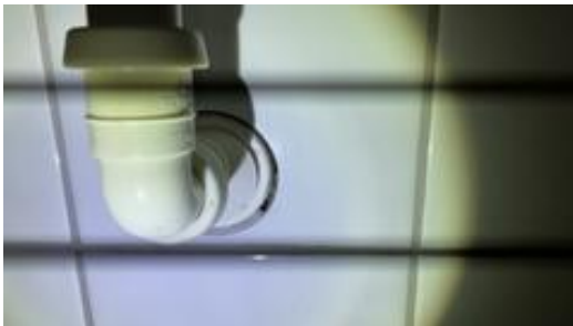
Ikke fuktett rørgjennomføring i vegg under vask.
