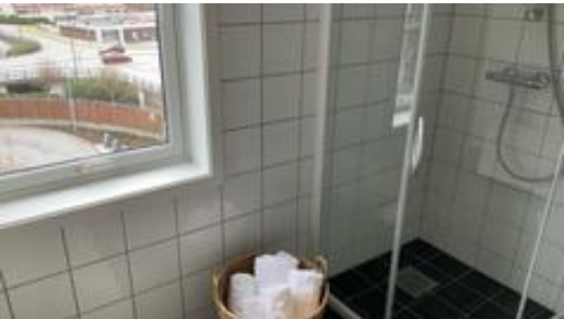
Vindu plassert i dusjens fuktsone.
