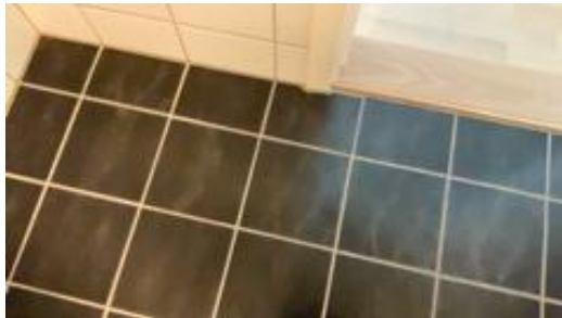
Bl.a bom/hulld under fliser i dette området.
