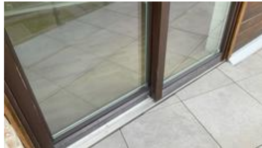
Oppkant i tre under skyvedør.
