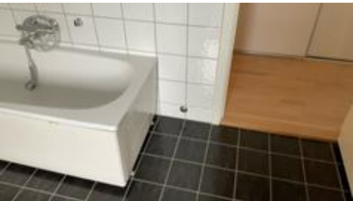
Dør plassert i badekarets fuktsone.
