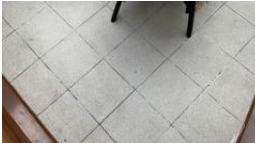
Avskallinger av flisefuger, bom/hulld under.
