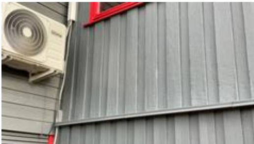
Tegn til nedbrytning og lokale råteskader i kledning.
