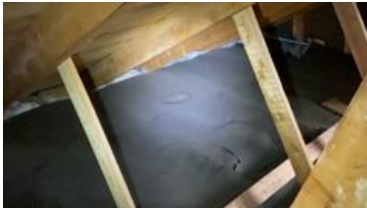
Merker etter tidligere fukt på isolasjonspapp på loft.
