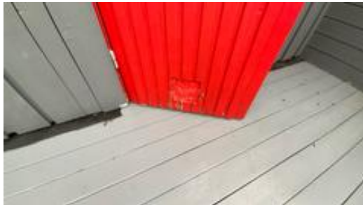
Terrassedør fra byggeåret. Døren har hull etter tidligere katteluke, som har blitt provisorisk tettet med byggeskum.
