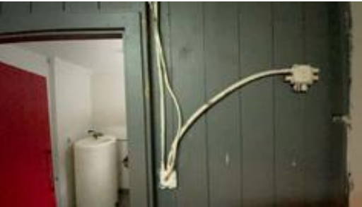
Ufagmessig strømoopplegg i underetasje.
