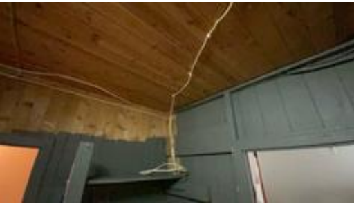
Ufagmessig strømoopplegg i underetasje.
