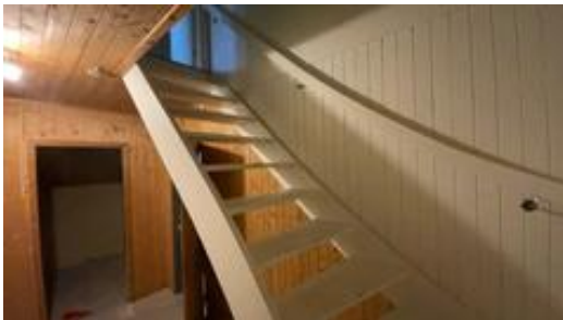
Innvendig trapp mangler rekkverk og har for store åpninger mellom trinn.
