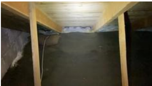
Det er ikke etablert luftespalter ved takfot.
