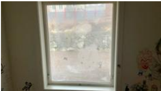
Punktert vindu i soverom.
