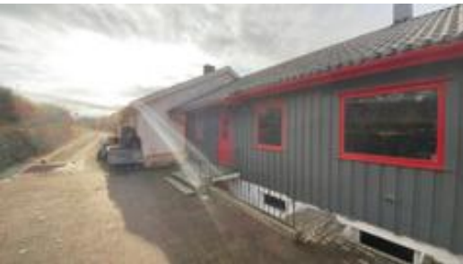
Terreng på oppside har svakt fall inn mot grunnmur.
