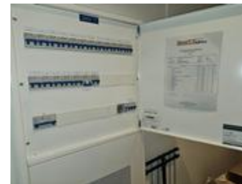
Sikringskap med automatsikringer og kursfortegnelse
