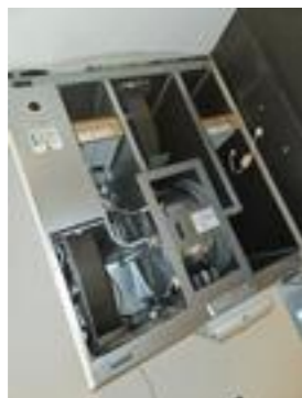
Balansert ventilasjon med varmegjenvinner
