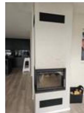
Innebygd vedovn i stuen. Skjult stålpipes.
