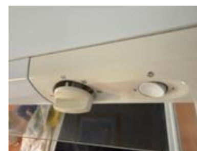
Bryter til ventilator står noe ut
