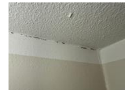
Glipp i fuge ved tak på stort soverom.
