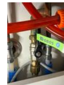
Hovedstoppekran i kjøkkenbenk.
