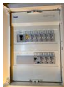
Automatsikringer med skap i entre.
