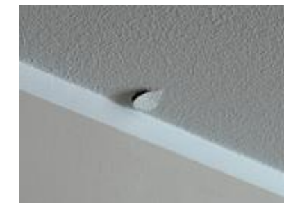
Løstnet mindre område med maling/puss i stuetak.
