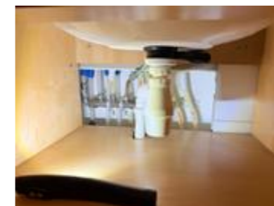
Røropplegg i servantskap
