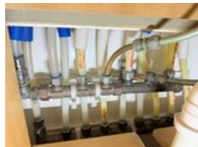
Manglende sprutdeksel foran rørskap.
