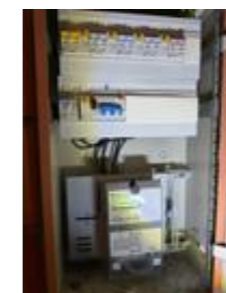
Elskap, plassert i felles trappegang.
