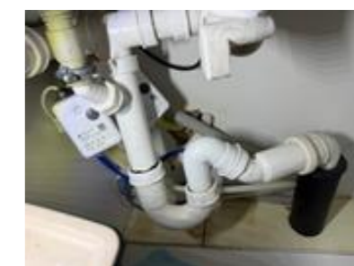
Røropplegg i kjøkkenbenk
