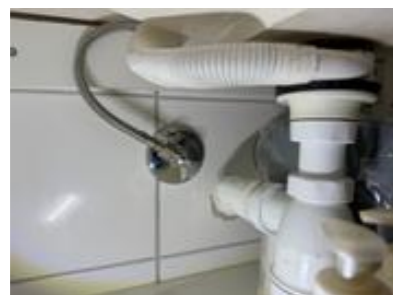
Røropplegg i servantskap
