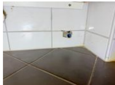
Manglende siklemikk foran drenerør fra rørskap
