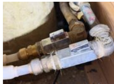
Stoppekraner også bak luke ved toalett i lite bad.
