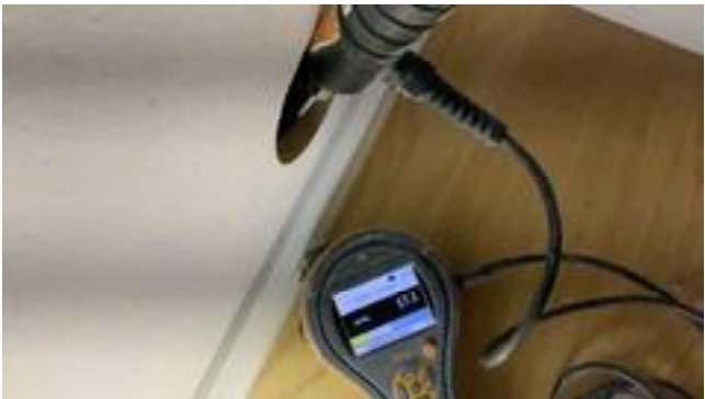
Fuktsøkt i påforet yttervegg.
