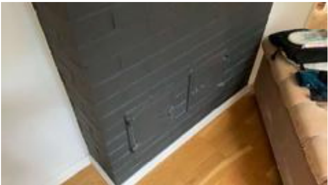
Feieluker, mangler ildfast plate på gulv under.
