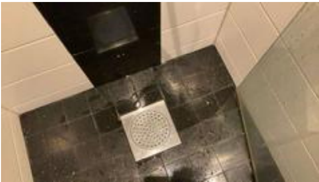
Noe vann vil bli stående på gulv/fliser i dusj etter bruk.
