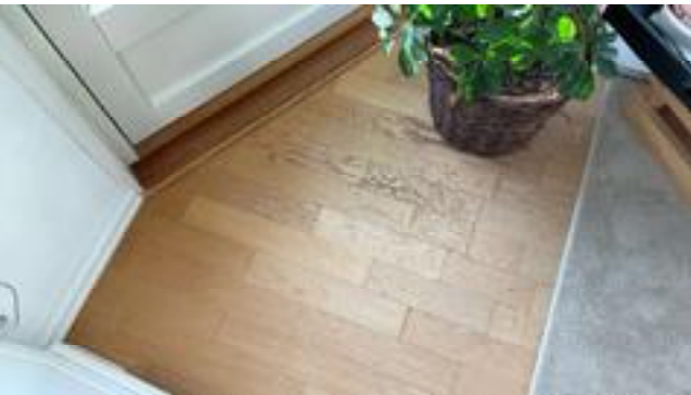
Bruksslitasjer/merker i parkett, her ved balkongdør.
