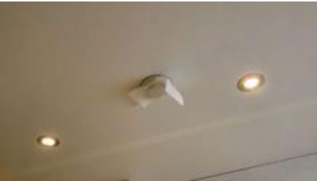
Avtrekk funksjonstestet med papir.
