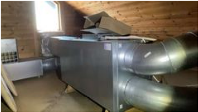
Motor for ventilasjonsanlegget.
