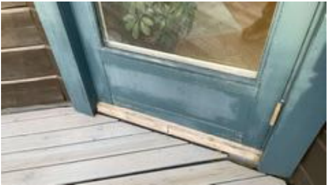
Råteskader på brystning.
