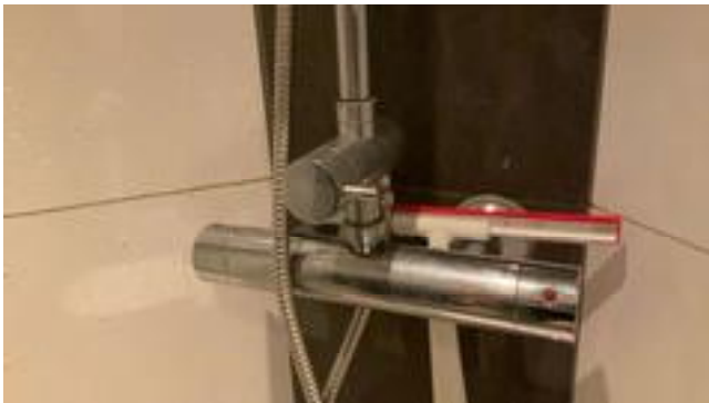
Lekkasjer fra overganger på termostat.
