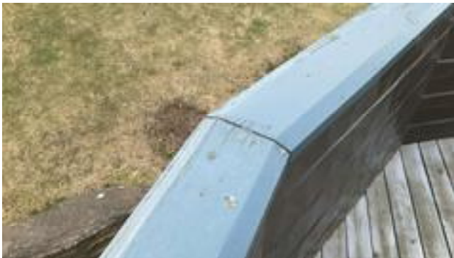
Oppsprikking av rekke.
