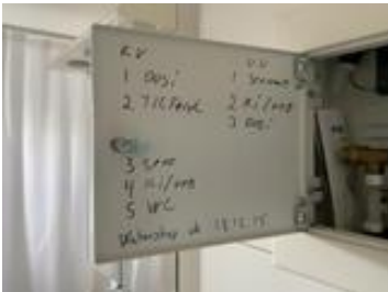
Rør i rør med kursfortegnelse.
