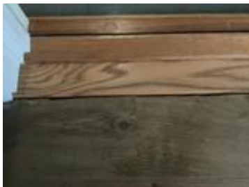
Manglende avslutning på entredør.
