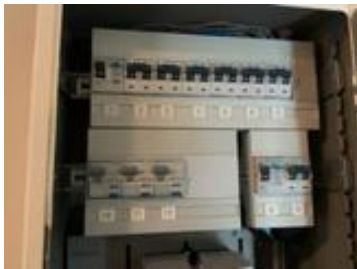
Sikringsskap med automatsikringer.
