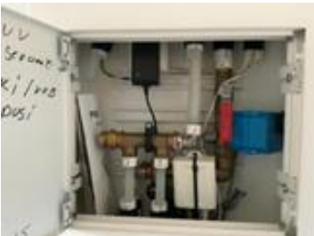
Fordelskap rør i rør.
