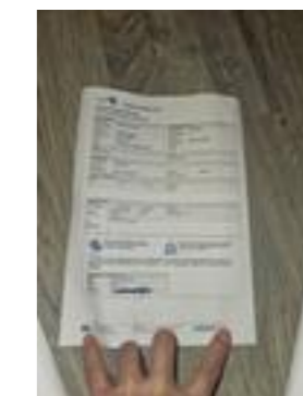
Samsvarserklæring ligger i sikringskapet
