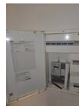
Sikringskap med automatsikringer og kursfortegnelse
