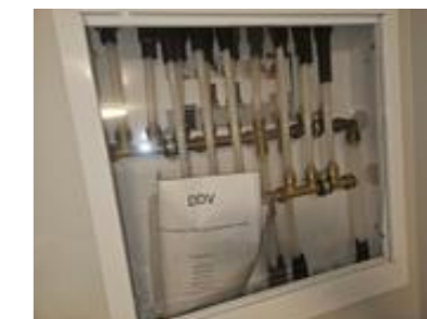
Fordelingsskap for tappevann
