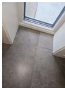
Litt "bom" under enkelte gulvfliser, bla her foran vinduet
