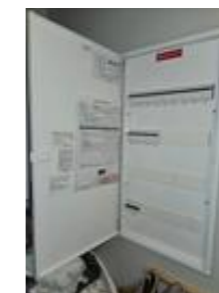
Sikringskap med automatsikringer og kursfortegnelse
