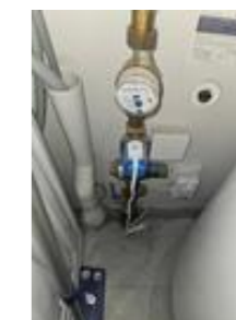
Stoppekran, reduksjonsventil og måler for vann
