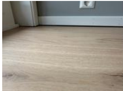
Glippe mellom gulv og fotlist/foring på dør.
