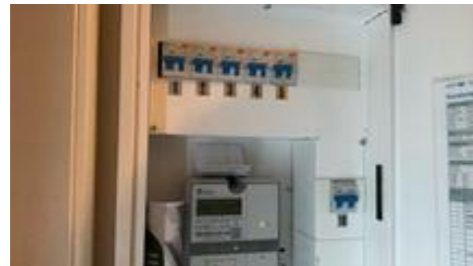
Sikringsskap med automatsikringer.
