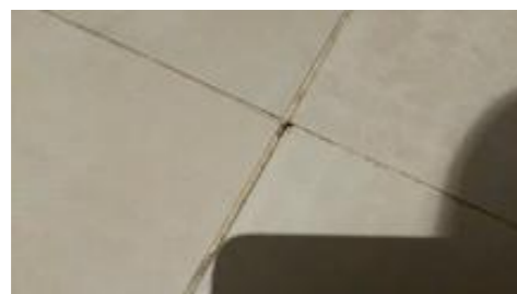
Sprekk/utvasket fuge i dusjsone.
