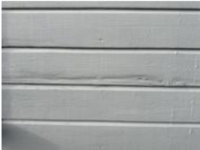
Råte i bordkledning
