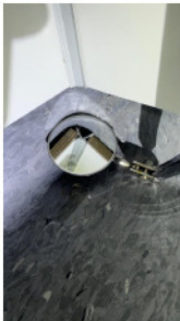
Bilde viser underkant av baderomsplater i dusjsone
