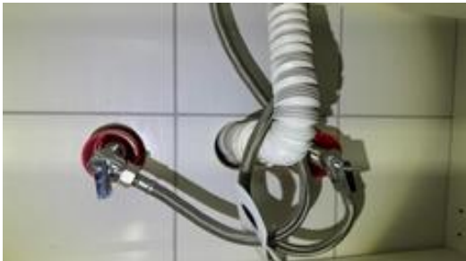
Bilde viser utførelse rundt rørgjennomføring under servant
