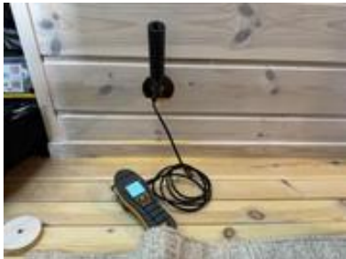
Bilde viser fuktmåling mot dusjsone
