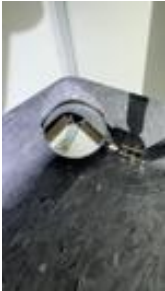
Bilde viser underkant av baderomsplater i dusjsone
