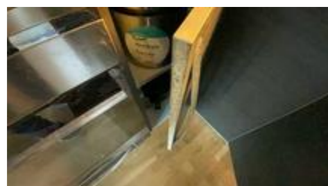
Manglende dekklist på front.
