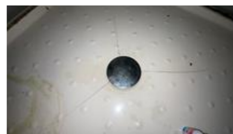
Sprekker i gulvet i dusjkabinettet.
