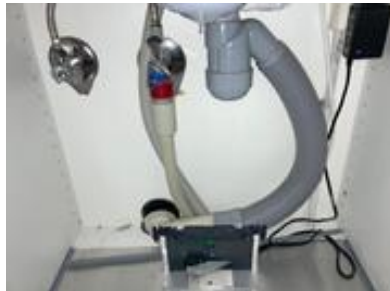
Røropplegg i skap under vask
